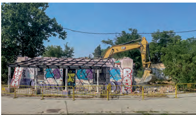
Momento en el que es derribado el edificio abandonado de La Torreta en la Carretera de Loeches
